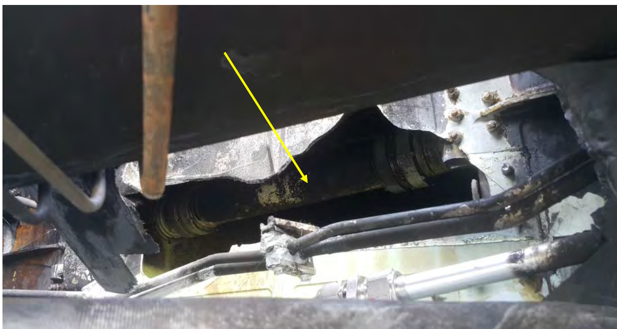
Рис. 16. Отверстие в стенке лонжерона правой консоли (указано стрелкой)
