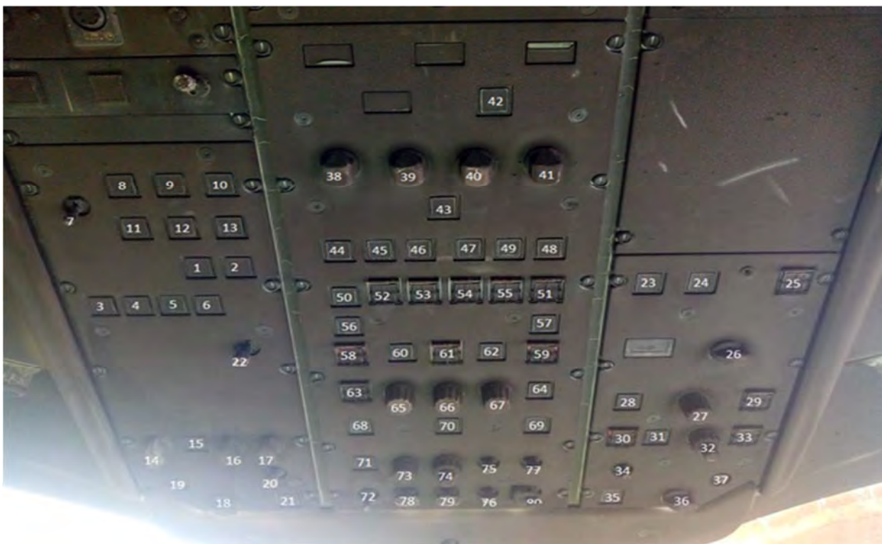
Рис. 22. Состояние кнопок аккумуляторных батарей после АП
